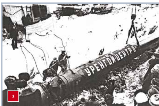
НА ТРАССЕ ГАЗОПРОВОДА УРЕНГОЙ – ЦЕНТР: "КРАСНЫЙ СТЫК"
